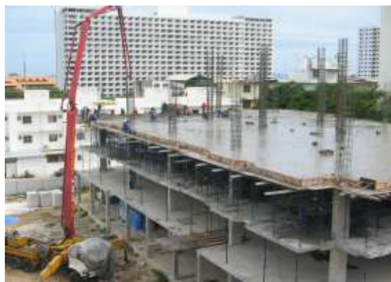
รูปที่ 4.61 การเทคอนกรีตพื้นด้วยระบบปั๊มส่งคอนกรีต (PUMPING CONCRETE) ซึ่งสามารถส่งคอนกรีตไปยังที่เทได้อย่างรวดเร็วลดการเสื่อมคุณภาพการก่อตัวของปูนซีเมนต์
