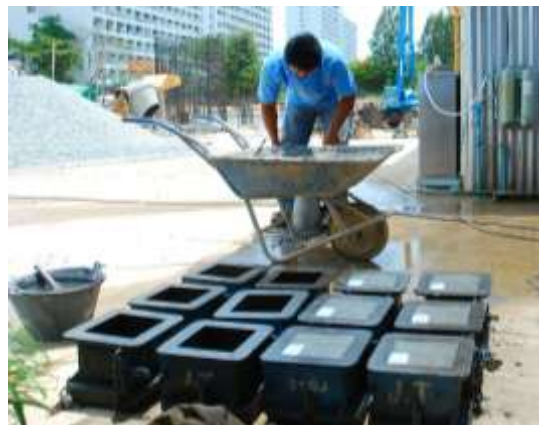
รูปที่ 4.65 การเก็บตัวอย่างคอนกรีตหน้างาน
