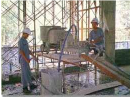
รูปที่ 4.128 Grouting ด้วยน้ำปูนระบบ Bonded System เข้าไปในท่อร้อยสลิ่ง
