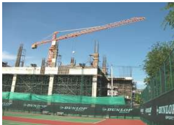
รูปที่ 4.59 การลำเลียงคอนกรีตไปเทลงในแบบหล่อคอนกรีตโดยทาวเวอร์เครน
