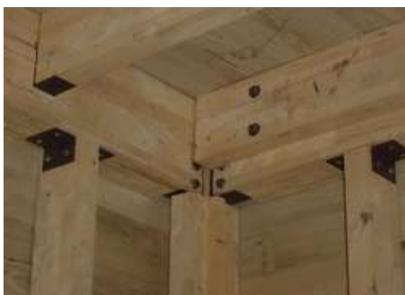
รูปที่ 4.17 แสดงโครงสร้างเสา คาน ตงไม้ โดยใช้เหล็กฉากเป็นตัวยึดและรับกำลัง
