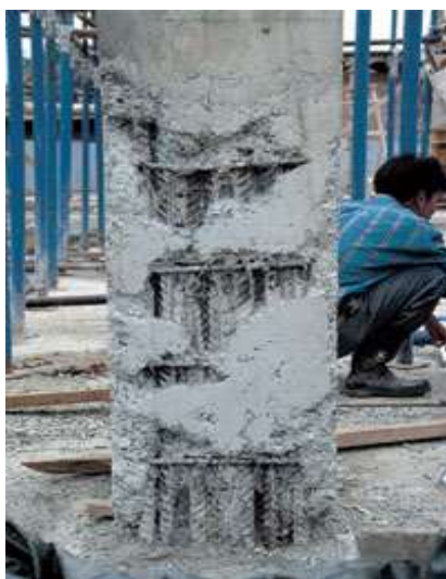
รูปที่ 4.70 การเทคอนกรีตที่ไล่ฟองอากาศไม่หมดอาจเกิดจากสาเหตุเหล็กแน่นเกินไปหรือคอนกรีตมี Slump ไม่เหมาะกับการเทเสา
