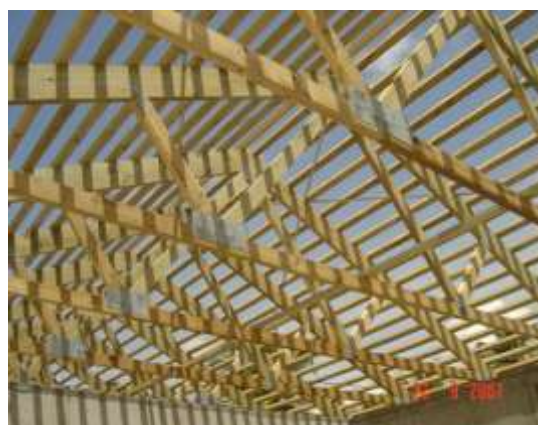
รูปที่ 4.25 แสดงจันทัน แปร ออกไก่ ค้ำยันไม้ ในโครงสร้าง Truss
