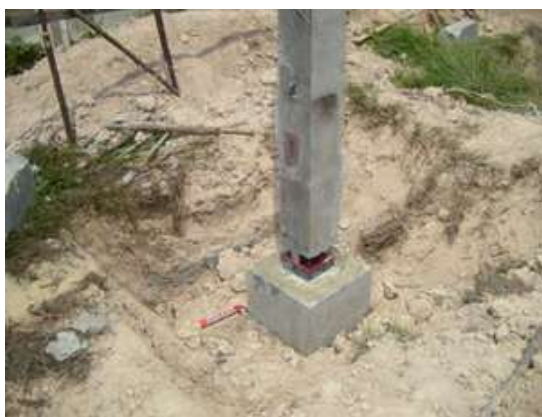
รูปที่ 4.94 จุดต่อระหว่างเสาและฐานรากสำเร็จรูป
