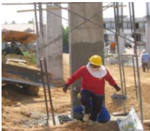
รูปที่ 4.68 การแต่งผิวปูนที่มีรูพรุนแต่ไม่ลึกถึงเนื้อเหล็กด้วยปูนทรายหรือปูนเก๊าท์เฉพาะทาง
