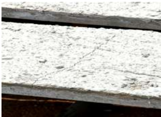
รูปที่ 4.110 พื้นสำเร็จรูปมีรอยแตกร้าว บริเวณกึ่งกลาง ไม่สามารถรับแรงได้อาจ เกิดความเสียหายจากการขนส่ง
