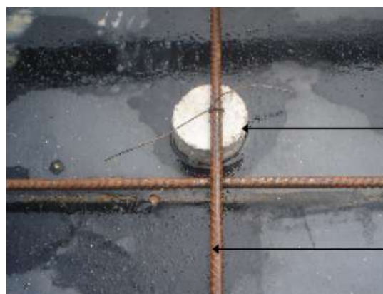
รูปที่ 4.57 การหุนลูกปูนก่อนเทคอนกรีต ให้ได้ระยะ Covering ถูกต้องตามแบบ
