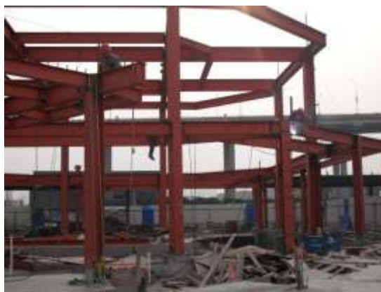
รูปที่ 4.27 แบบโครงเหล็กรูปพรรณ เสา คาน โครงหลังคา
