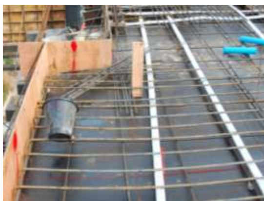
รูปที่ 4.56 แบบเทคอนกรีตต้องมีระดับอ้างอิง (สีแดง) ก่อนเทคอนกรีต
