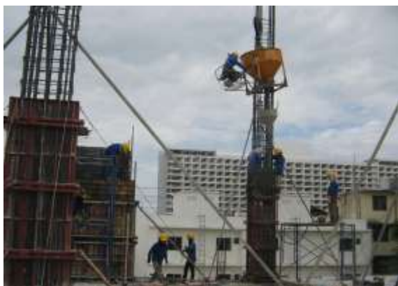
รูปที่ 4.60 การเทคอนกรีตเสาโดยใช้บั๊กเก็ต (BUCKETS) และมีกรวยรับคอนกรีตพร้อมท่อผ้าใบส่งคอนกรีตไปยังแบบหล่อเสาเพื่อลดการกระแทกของคอนกรีตกับเหล็กเสริม
