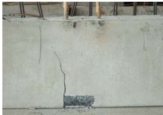
รูปที่ 4.111 คานคอนกรีตสำเร็จรูปที่มีรอยแตกร้าวไม่สามารถใช้งานได้
