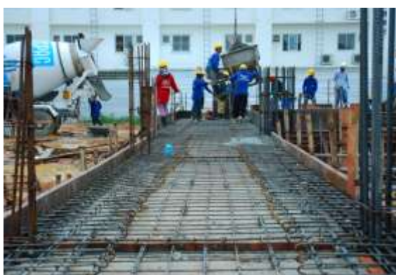
รูปที่ 4.80 การผูกเหล็กเสริมในพื้นที่คอนกรีต เสริมเหล็ก
