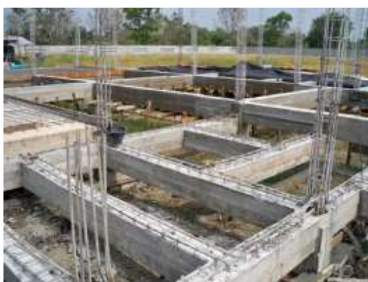
รูปที่ 4.51 การเว้นช่องสำหรับสอดเหล็กพื้นในการเทพื้นที่หลัง
